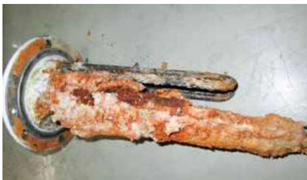
Verkalktes Heizregister reduziert die Heizleistung.
